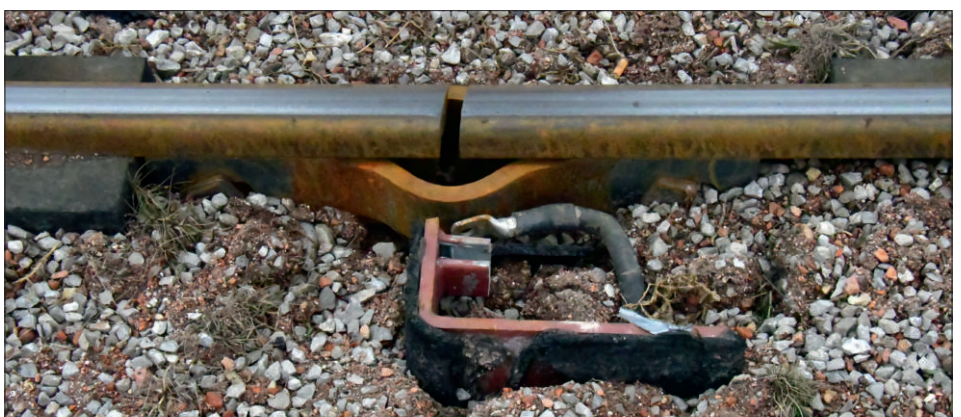
Mitte und unten: Schienebrüche auf zwei unterschiedlichen Gleisen, vor der Haltestelle Schulkowitzgasse.
